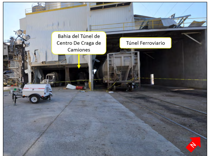
Figura 18. Imágenes posteriores al incidente de los "túneles" de carga de camiones y los rieles. Al momento del incidente, los cargadores estaban trabajando en el túnel y presenciaron fuego y llamas provenientes del túnel del extremo oeste.
