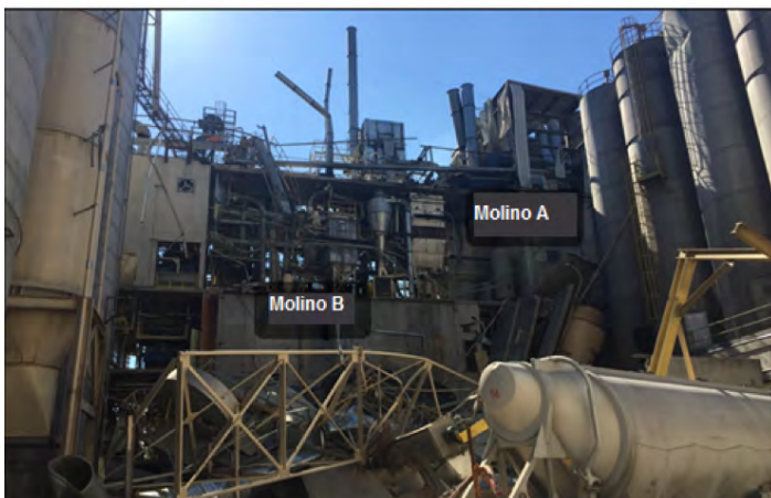
Figura 5. Vista del costado este de la instalación de Didion antes del incidente tomada a finales de 2010 (arriba) y posterior al incidente (abajo) que muestra el colapso completo del molino F y la sala de calderas. La fotografía anterior al incidente muestra la instalación antes de que se agregaran el molino D o las bahías de carga a granel expandidas.
