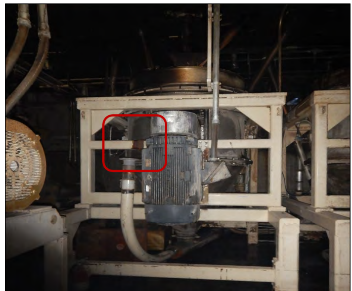
Figura 12. El superintendente vio el filtro de la línea de entrada de aire del molino sur volando por los aires y una llama de tres a cuatro pies saliendo de la misma línea (caja roja, imagen superior). La dirección del flujo de las llamas iba en la dirección contraria al flujo normal de aire en el molino triturador (gap mill) (ver Figura 10).
